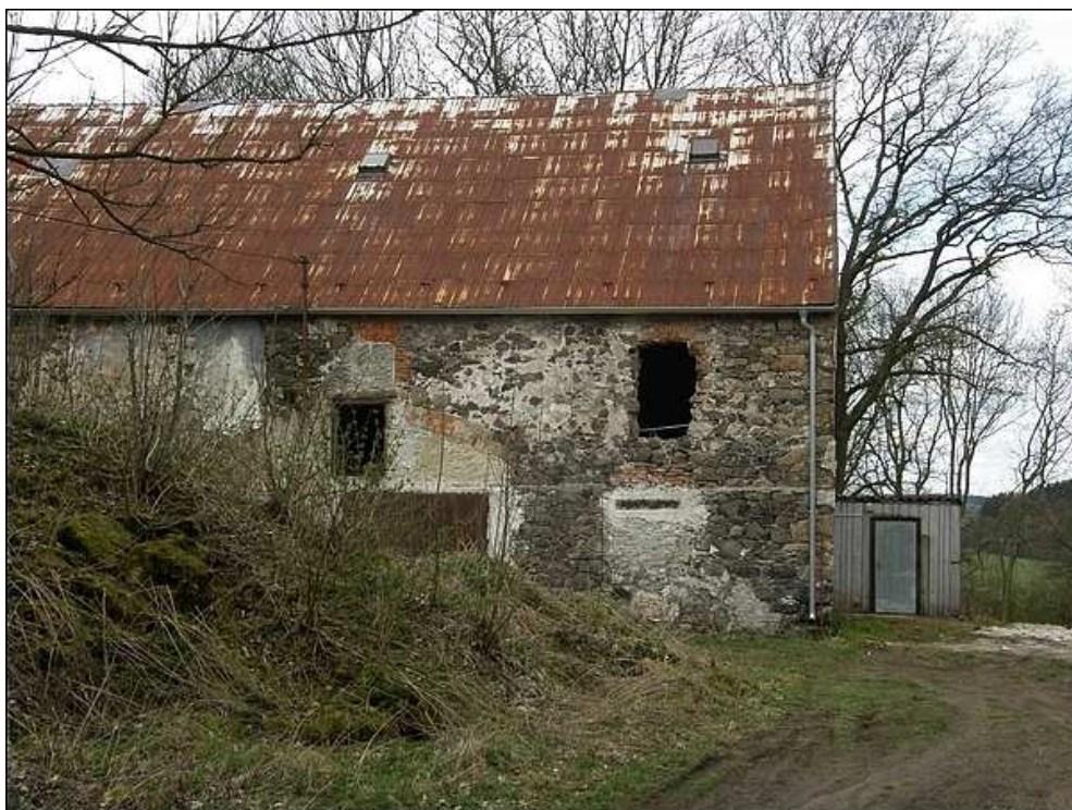
F22 – chátrající objekt
